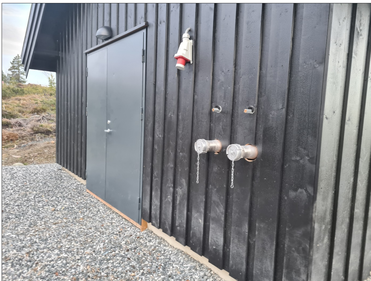
Figur 8. Eksempel på tappepunkt for brannvann, fra Trollset Vannverk. Brannventilene er lett tilgjengelig og det er god oppstillingsplass/snuplass fremfor bygget.
