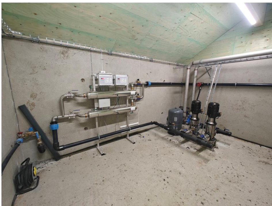
Figur 9. Bildet viser eksempel på vannbehandlingsanlegg med UV-behandling og trykkøkningspumper til forsyning til forbruker. Det må i tillegg etableres filter for mangan-fjerning.
