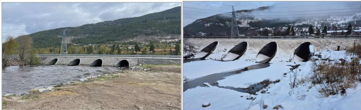
Figur 3.5: Rukkedøla, kulverter gjennom veifyllingen av rv. 7, 07.05.2024 og 26.11.2024.
