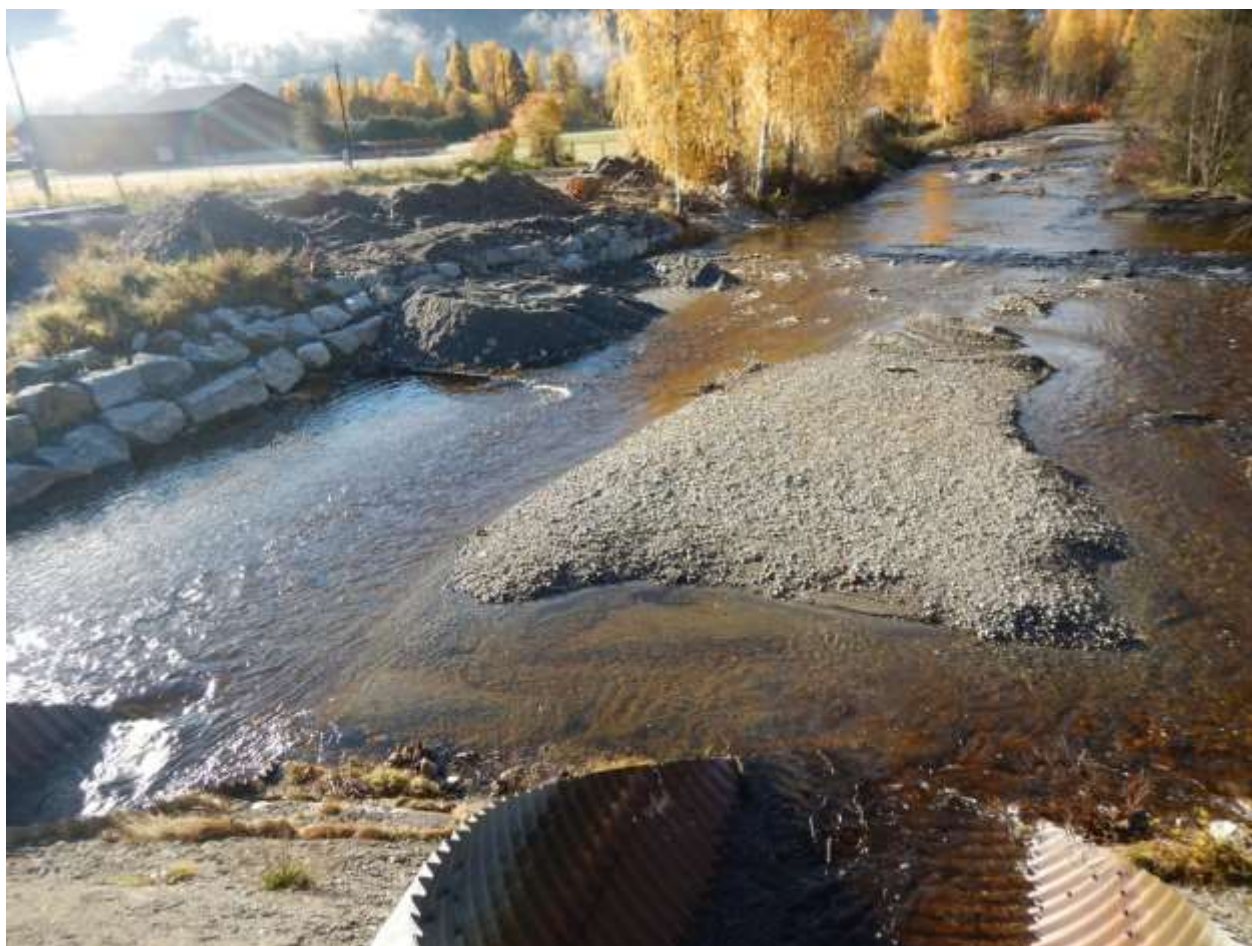
Figur 11 Rukkedøla har lagt opp grus der elva renner inn under Rv. 7. Denne oversvømmes jevnlig og vegetasjonen etableres svært seint på grunn av stadig flom.
